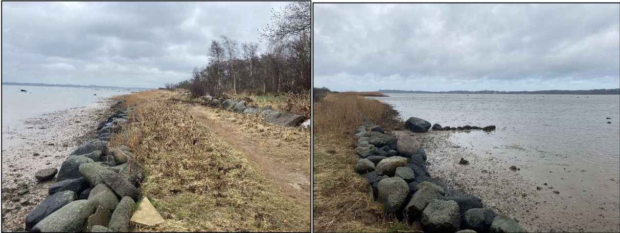
Figur 2.12: Til venstre: Erosionsbeskyttelse ved matrikel 1f. Foto: NIRAS (d. 6-4-2022). Til højre: Erosionsbeskyttelse ud for matrikel 1n og 14y. Foto: NIRAS (d. 6-4-2022).
