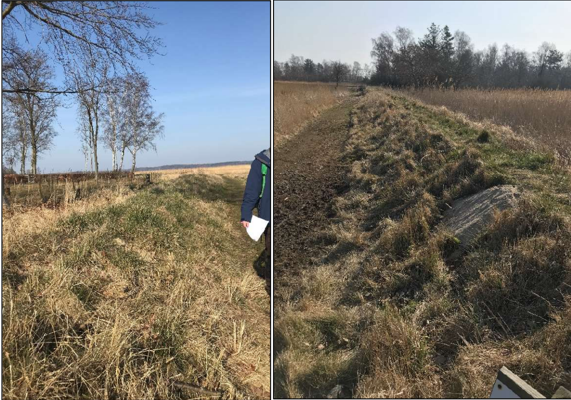
Figur 2.20: Til venstre: Diget ud for matrikel 7u set mod nordvest. Foto: NIRAS (d. 22-3-2022). Til højre: Diget ud for matrikel 7s set mod øst. Foto: NIRAS (d. 22-3-2022).
