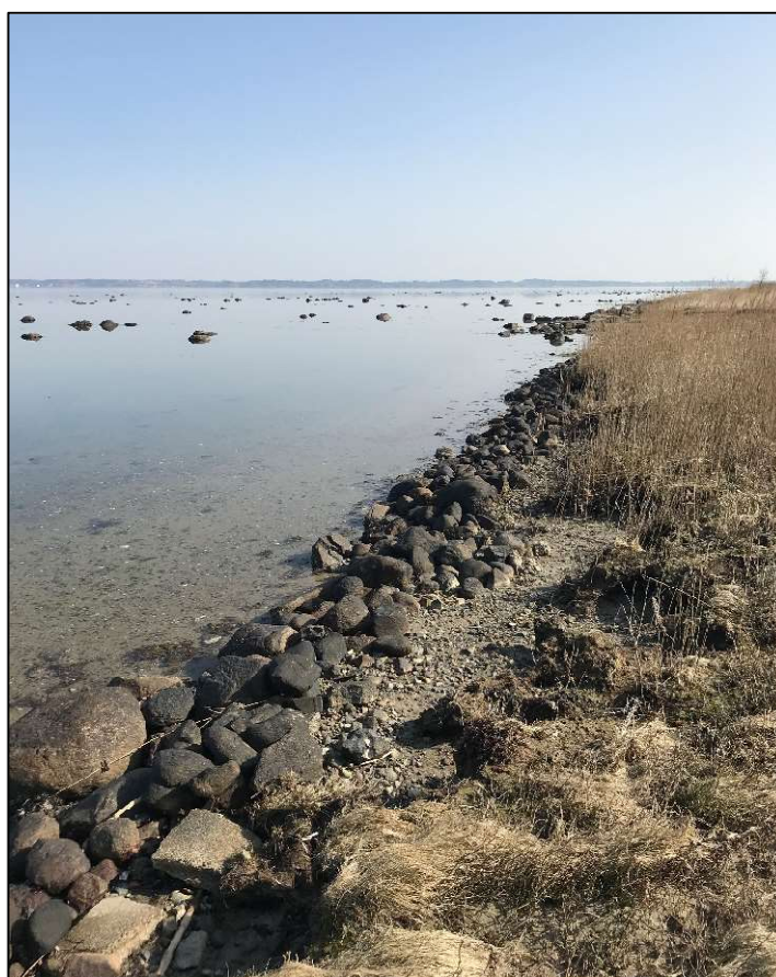
Figur 2.15: Erosionsbeskyttelse ud for matrikel 14x og 14y. Foto: NIRAS (d. 22-3-2022). På fotoet ses der erosionskår bag stensætningen.
